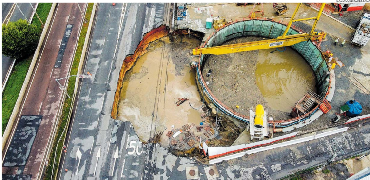
A cratera que surgiu na Marginal do Tietê após desabamento na obra do Metrô atingiu três faixas da pista local; trânsito no sentido Rodovia Ayrton Senna foi interrompido
